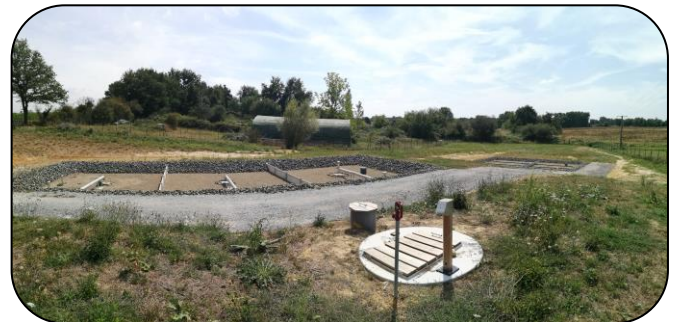
Station d'épuration de CASTANDET
