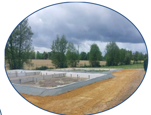
Station d'épuration de LE VIGNAU
