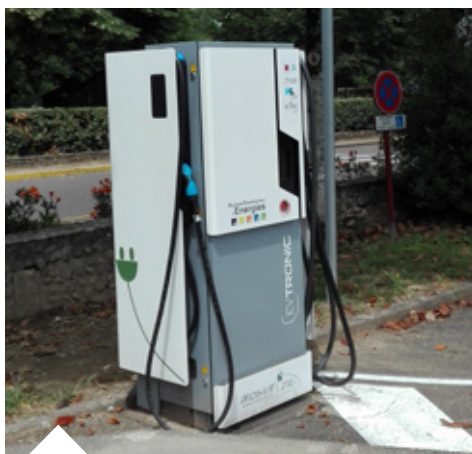
La maîtrise d'ouvrage et la maintenance des infrastructures de recharge pour véhicules électriques ou hybrides sont assurées par le Sydec.
