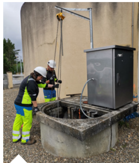
Les différents ouvrages du réseau d'assainissement font l'objet d'un suivi rigoureux.
